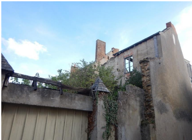
Figure 3 : Bâtiment situé au 7 place Saint Pierre, façade nord côté cour, vue depuis l'impasse Saint Jean
