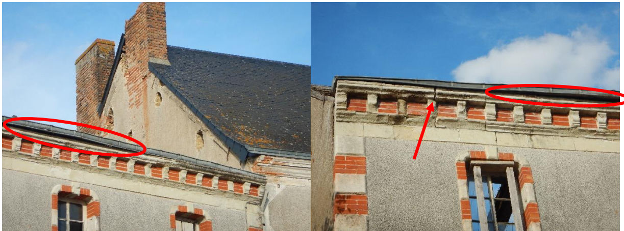
Figure 22 : Fissures et anfractuosités potentiellement favorables aux chiroptères
